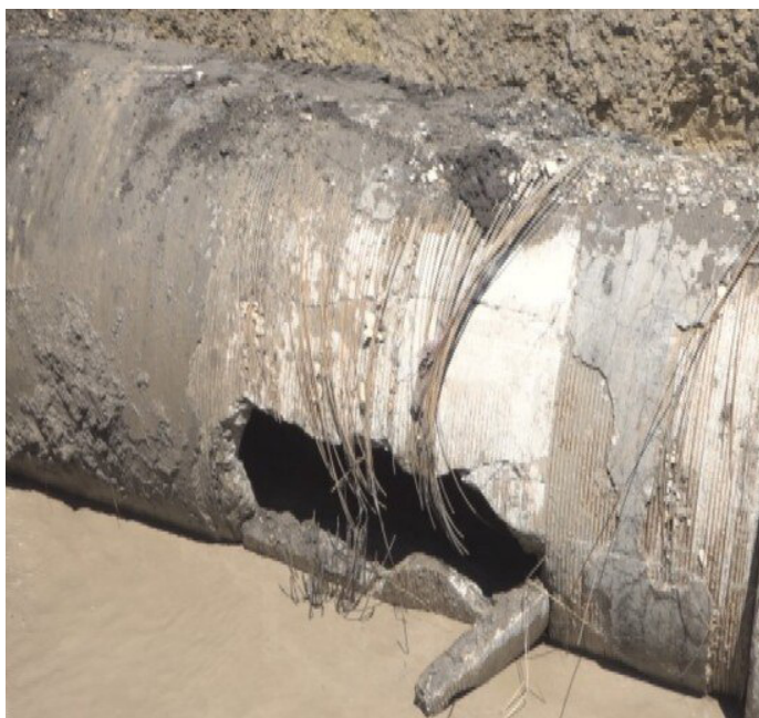
Un tubo danneggiato. Foto Ansa
