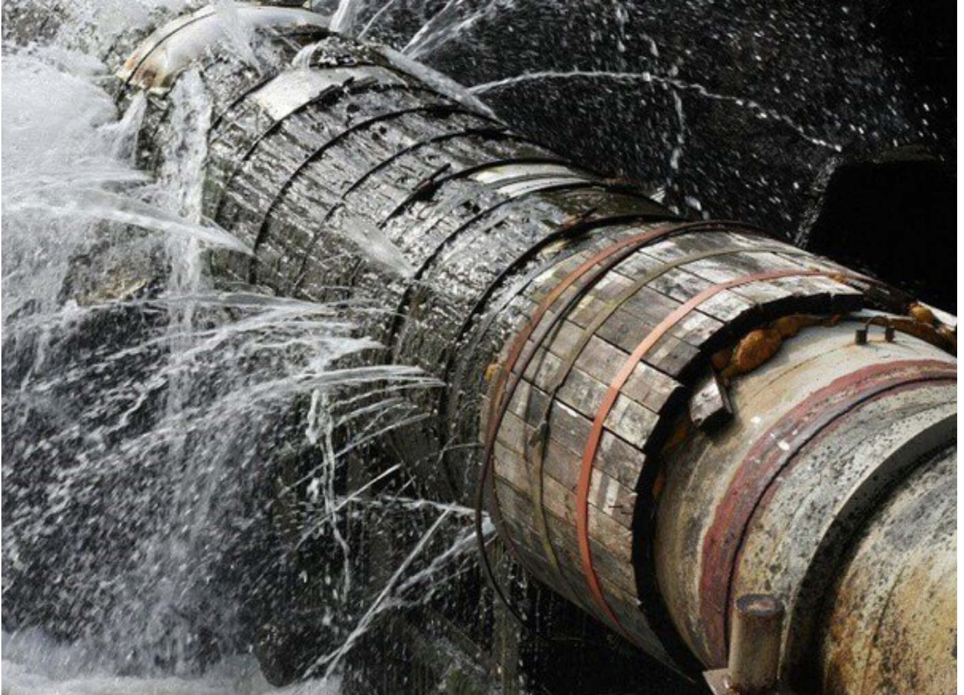
Una tubatura danneggiata. Foto Ansa
